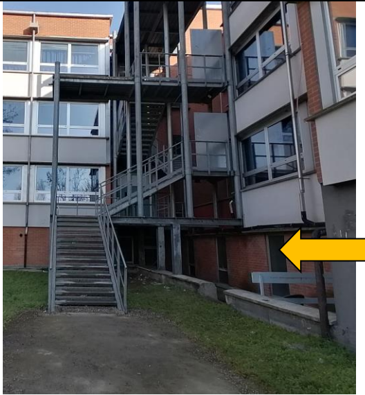
Fig. 1 Chiusura automatica di n. 3 infissi mediante tende tagliafuoco
